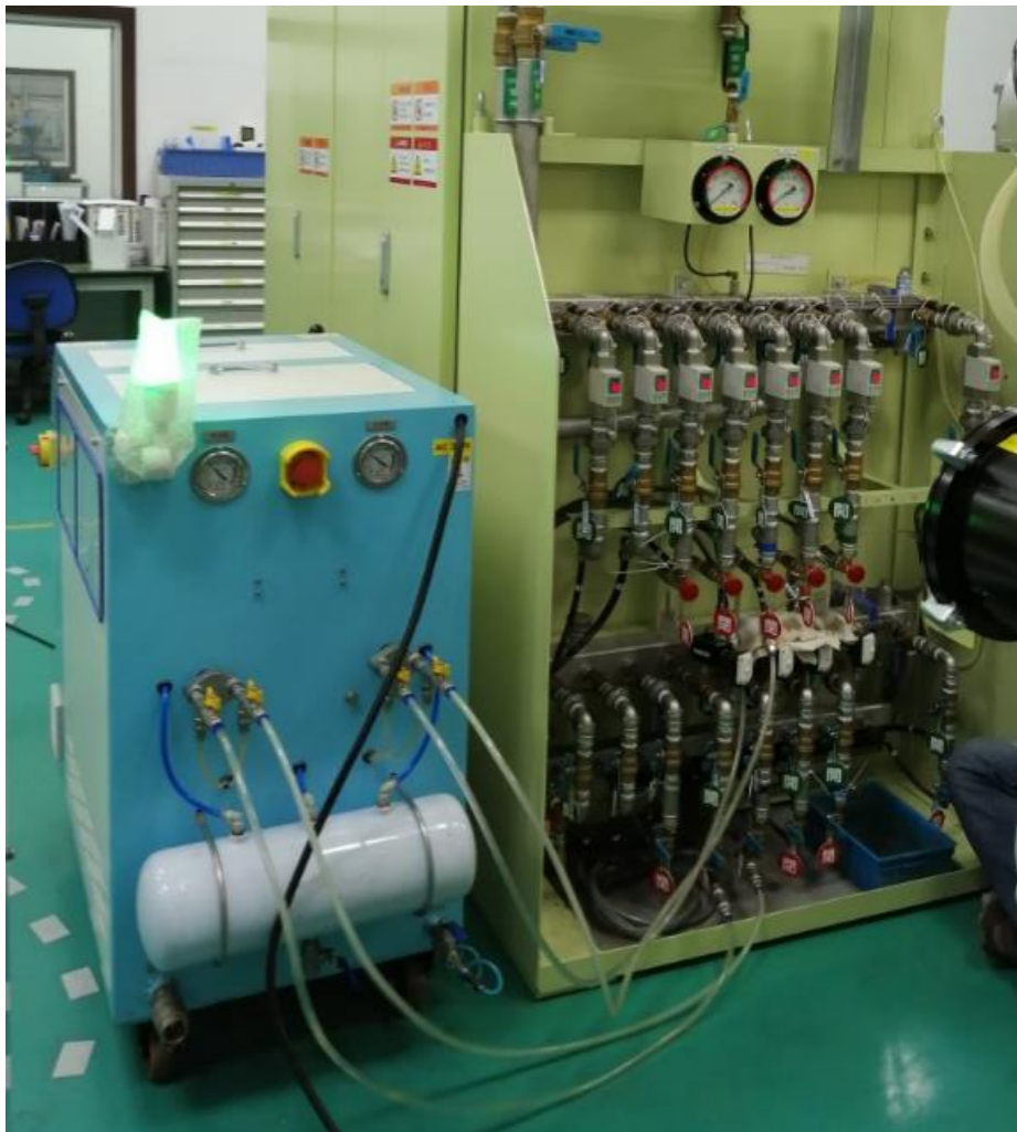
真空离子镀膜机冷却水路清洗
